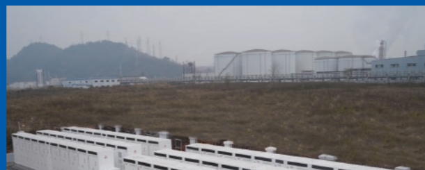
重庆长寿项目 5MW/10MWh
