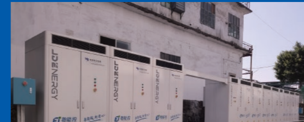
杭州钱江电气储能项目 516kW/1032kWh
