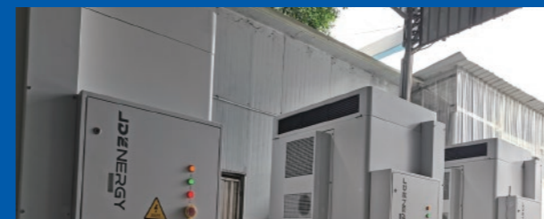
佛山冠叶项目 430kW/860kWh
