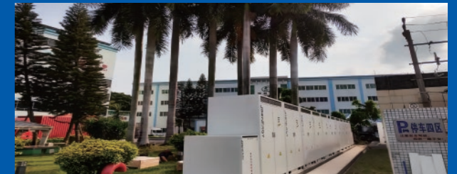
广州天活项目 1.29MW/2.58MWh
