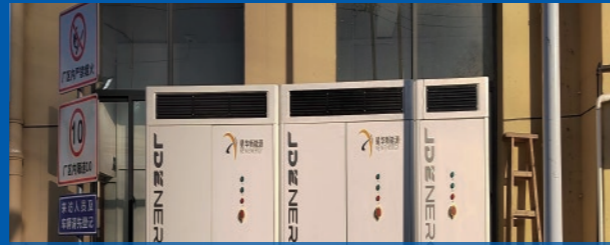
杭州星华项目 172kW/344kWh
