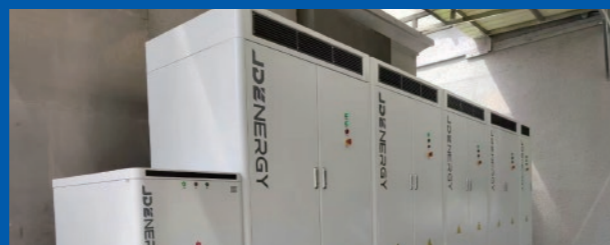
义乌文渊项目 344kW/688kWh
