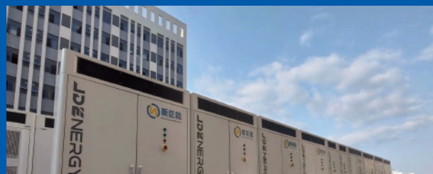
惠州盛联项目 1.2MW/2.4MWh
